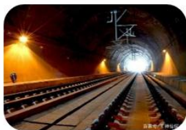
高铁智能隧道照明
